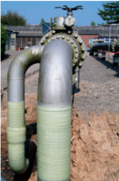
Abb. 4 GFK-Umhüllung beim Übergangsbereich Boden – Luft, hier bei einer Verdichterstation
