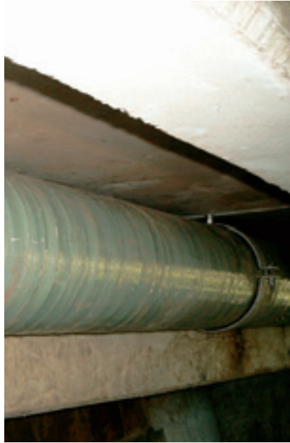
Abb. 5 Brückenleitung beschichtet mit einem Glasfaser verstärkten Kunststoff (GFK)
